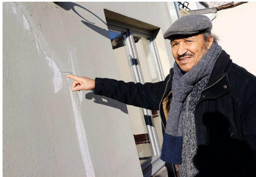
Cette année, de nombreuses fissures sont apparues dans l'habitation de Tejeddine. © BERNARD DEMOULIN
